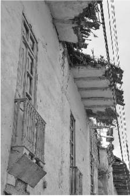
Fig. 2.2 Deterioro de las edificaciones del centro histórico de Loja.
