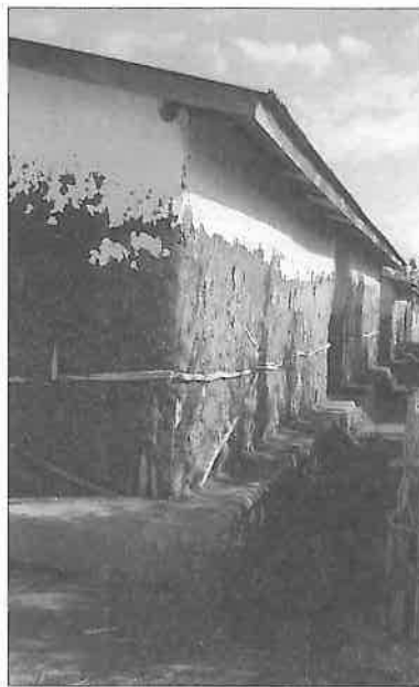
Ett problem med kalkfärg är att den regnar bort
