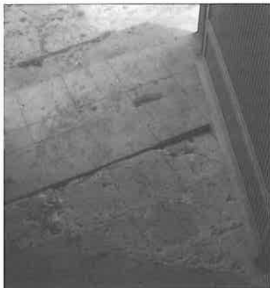
Spricka i golv
